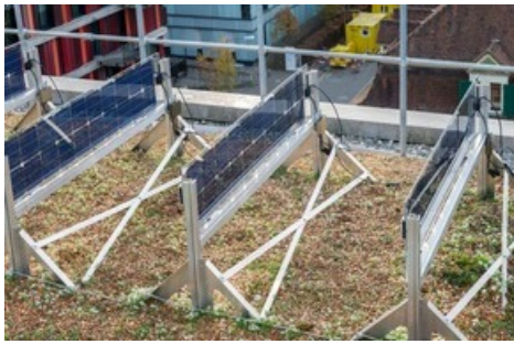
Eine helle Dachbegrünung führt zu mehr Stromertrag.
