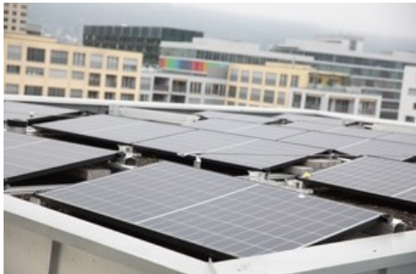
Blick auf die Solaranlage des im Jahr 2020 fertiggestellten Entwicklungsprojekts an der Steinwiesenstrasse in Schlieren
