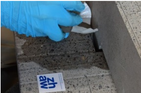
Die einzelnen Platten werden zusammengefügt und mit einem Vergussmörtel verbunden. Quelle: ZHAW.
