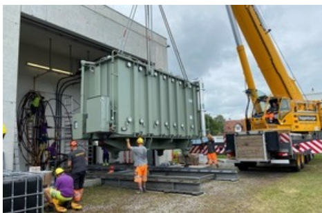
Zur gemeinsamen Nutzung des Unterwerks Salwiese wurde im Spätsommer 2021 ein spezieller Dreiwicklungs-Transformator eingebaut (Bild: SN Energie).
