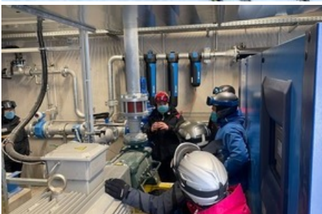
Besichtigung der Pumpstation Obersäss
