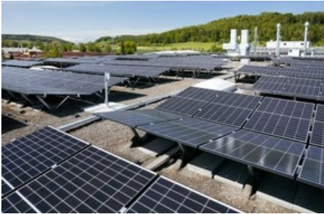
Photovoltaikanlage Wettswil a.A. / Weiterer Text über ots und www.presseportal.ch/de/nr/100001252 / Die Verwendung dieses Bildes ist für redaktionelle Zwecke honorarfrei. Veröffentlichung bitte unter Quellenangabe: "obs/AMAG Group AG"
