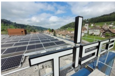
Die neue SAK Photovoltaikanlage, installiert auf dem Dach des Tisca Gebäudes in Bühler (Bild: SAK).
