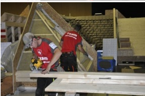
In der Kategorie Dachdeckungen holte die Schweiz an der diesjährigen Weltmeisterschaft junger Dachdecker zum zehnten Mal die Goldmedaille. Foto: Gebäudehülle Schweiz
