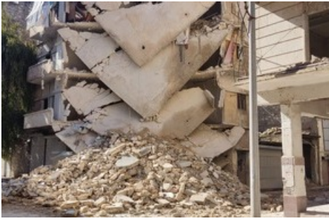
Vom Erdbeben zerstörtes Wohnhaus in Aleppo.
