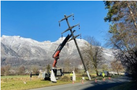
Rückbau eines 24 Meter hohen Betonmastes der ehemaligen 20kV-Freileitung bei Oberriet mit einem Pneukran (Foto: SAK).
