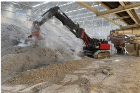
BILD zu OTS - Einblick in die Räumung der Deponie, die von einer semimobilen Überdachung vor Witterung geschützt wird
