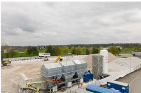
Die neue Grossanlage zur CO 2 -Speicherung in Biberist, Schweiz.
