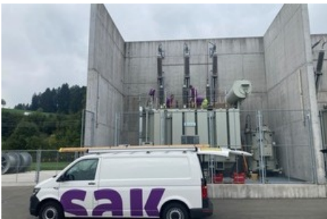
Laschen umstecken am Transformator im Unterwerk Wattwil (Bild SAK).
