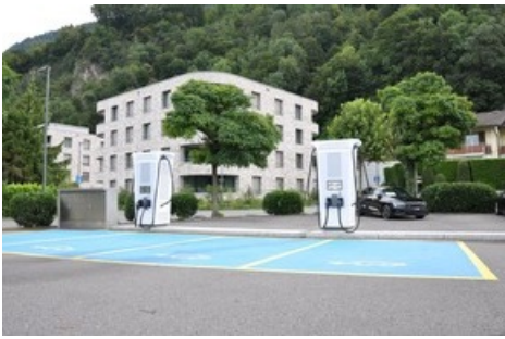
Foto_3_Schnellladestation_AMAG_Vaduz / Schnellladestation in Vaduz / Weiterer Text über ots und www.presseportal.ch/de/nr/100001252 / Die Verwendung dieses Bildes für redaktionelle Zwecke ist unter Beachtung aller mitgeteilten Nutzungsbedingungen zulässig und dann auch honorarfrei. Veröffentlichung ausschließlich mit Bildrechte-Hinweis.
