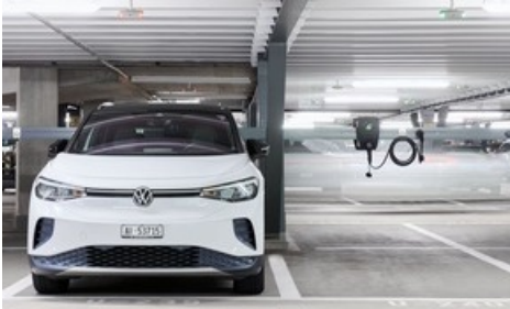
Foto_4_Ladehaus_Messe_Zürich / Ladehaus AMAG Parking Messe Zürich / Weiterer Text über ots und www.presseportal.ch/de/nr/100001252 / Die Verwendung dieses Bildes für redaktionelle Zwecke ist unter Beachtung aller mitgeteilten Nutzungsbedingungen zulässig und dann auch honorarfrei. Veröffentlichung ausschließlich mit Bildrechte-Hinweis.
