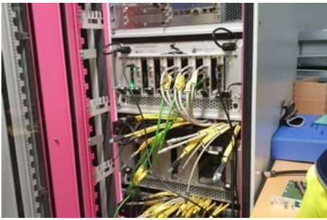
So sieht einer der über 20 Schränke mit Komponenten des Fast Beam Interlock-Systems aus, das die ZHAW entwickelt hat. Foto: Israa Ali/ESS
