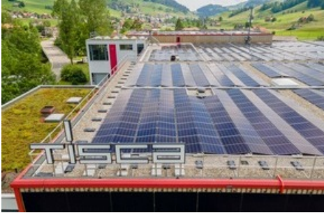
PV-Anlage auf Tisca Gebäude in Urnäsch (Bild SAK).
