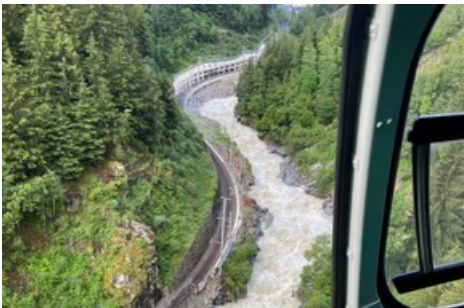
Unterspülung MGBahn-Streckennetz bei St. Niklaus
