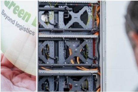
Lithium-Ionen-Batteriepakete speichern den tagsüber produzierten Solarstrom für den durchgehenden Betrieb / © Designwerk Technologies AG
