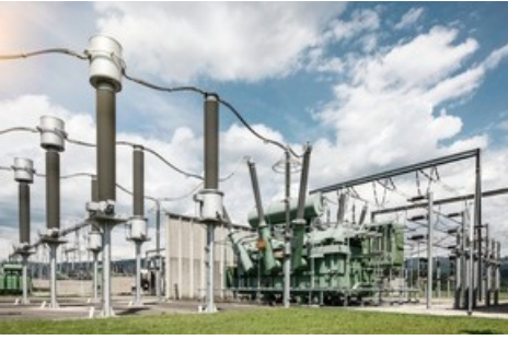
Unterstation Bassecourt. Foto: Philipp Zinniker
