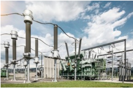
Unterstation Bassecourt. Foto: Philipp Zinniker
