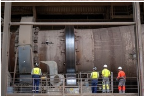
Mesures de les épaisseurs des parois en acier du four à ciment. ©Voliro
