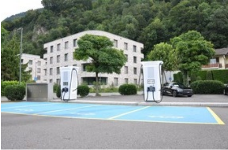
Foto_3_Schnellladestation_AMAG_Vaduz / Texte complémentaire par ots et sur www.presseportal.ch/fr/nr/100001252 / L'utilisation de cette image à des fins éditoriales est autorisée et gratuite, pourvu que toutes les conditions d'utilisation soient respectées. La publication doit inclure le crédit de l'image.
